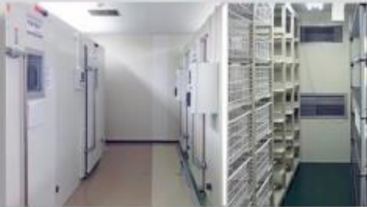
恒温恒湿室(7室)・恒温室(2室)
